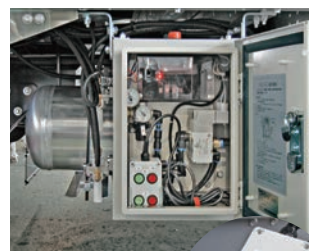
コントロールボックス
