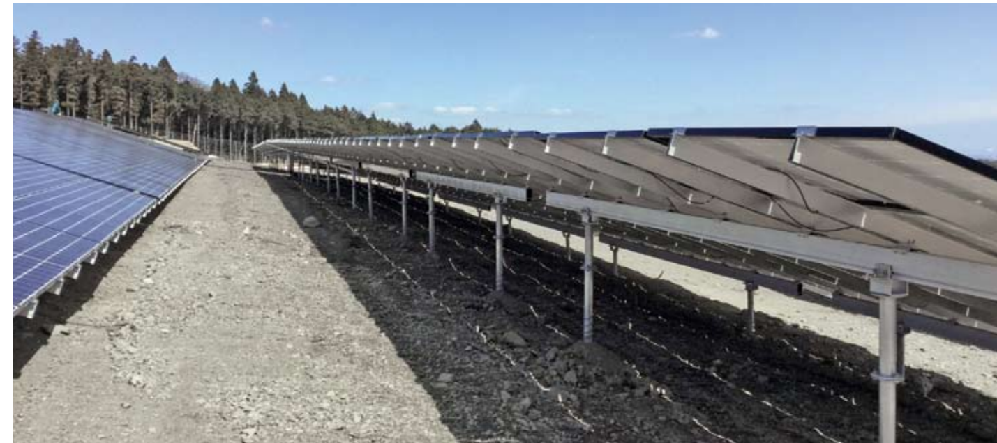
▲大型物件施工例 (可変角度ブラケット+ 傾斜角調整ファスナー)
