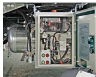
コントロールボックス
