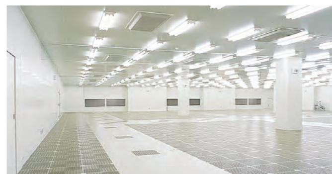
▲ システム天井 天井補強材
